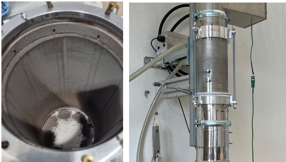
Abbildung 8: links: Abschabung der Ablagerungen durch die feststehenden Metallsaiten bei Drehung des Abgasrohrs; rechts: am Ofen eingebauter Apparat mit Rückzugfeder und Gewicht
