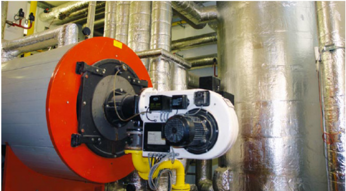
Neuer Heizkessel in der Gewerbeschule Lörrach
