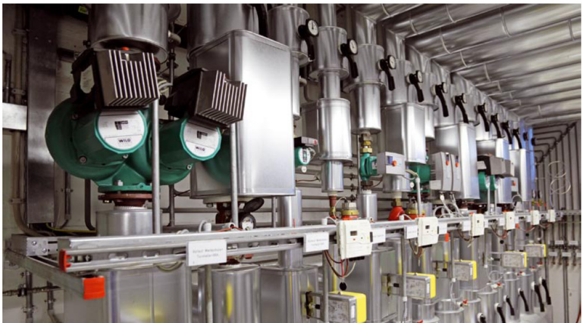
Sanierte Heizungsanlage im Bildungszentrum Denzlingen
