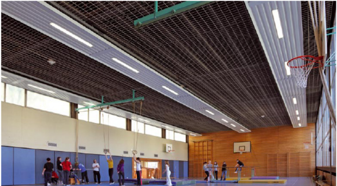
Deckenstrahlplatten-Heizung in der Jahn-Halle, Denzlingen
