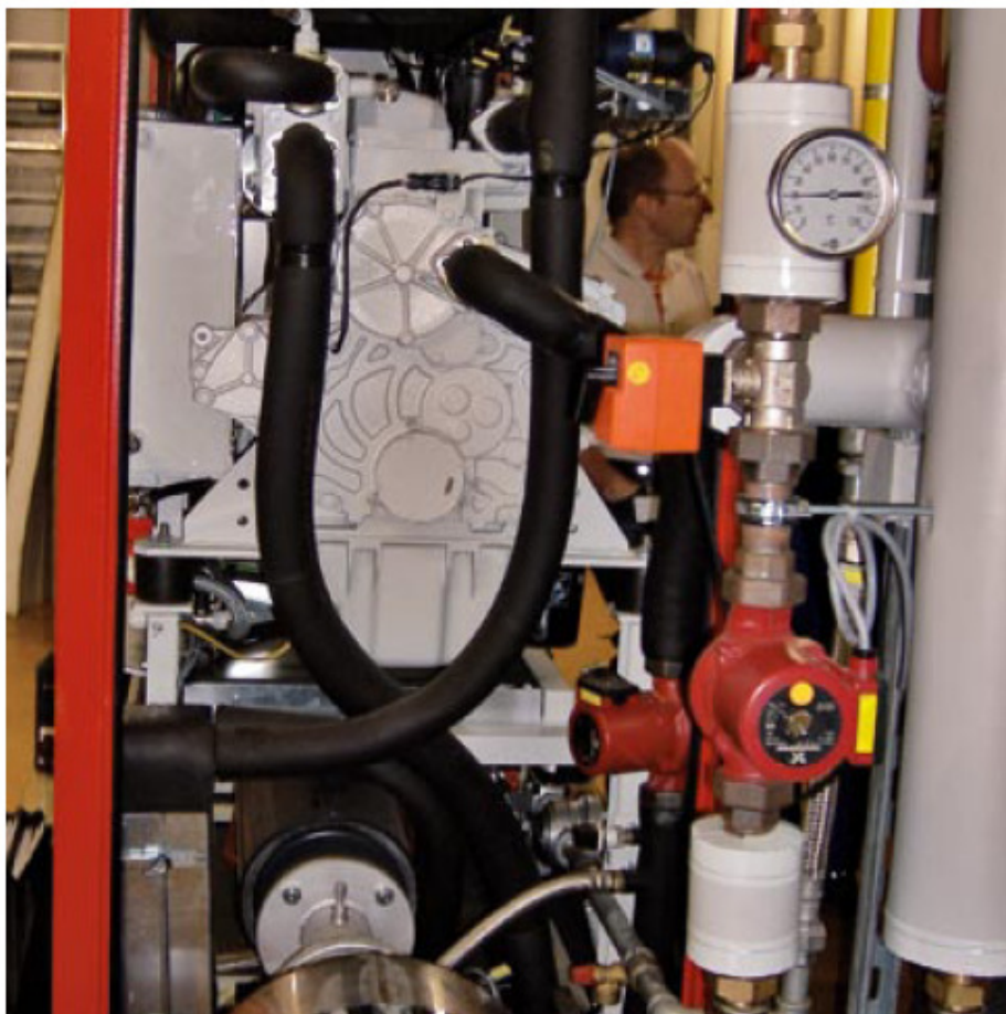
Blockheizkraftwerk im Rathaus Lörrach
