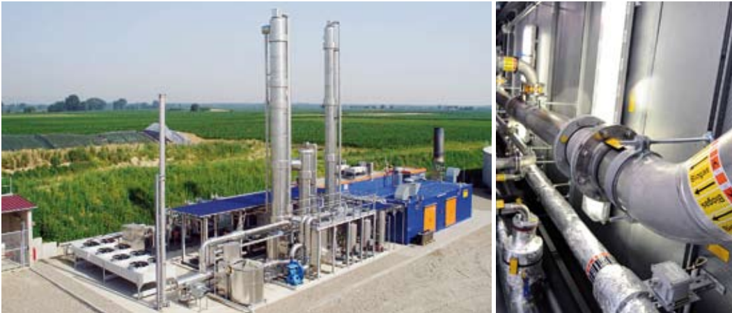
Die Biogasaufbereitung in Forchheim.
