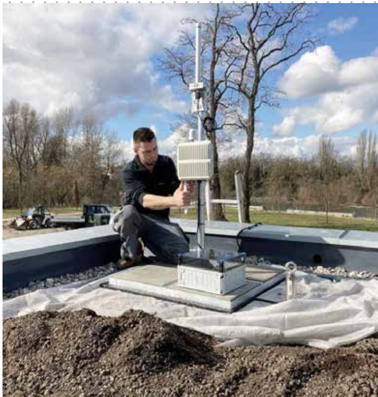
Alexander Brodbeck von Elektro Ullmann bei der Installation eines Gateways auf dem Landesgartenschau Gelände.
