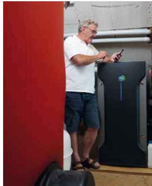
Eine Erdgas-Brennstoffzelle im Keller bedient effizient und klimaschonend den Energiebedarf in Privathaushalten. Harioolf Schmid aus Heitersheim hat sich 2020 für diese Lösung entschieden.
